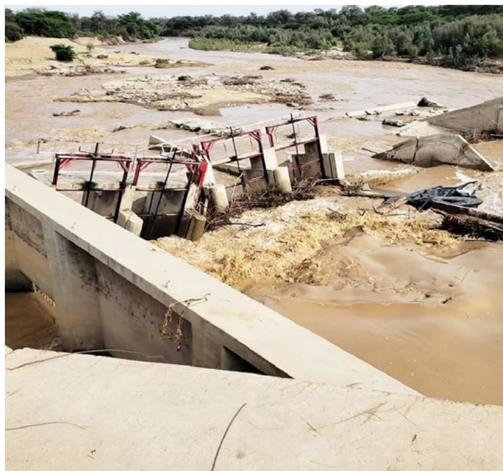
Compuertas de la Bocatoma Huaca de la Cruz colapsadas por el desborde del río La Leche, ocurrido el 15 último.
