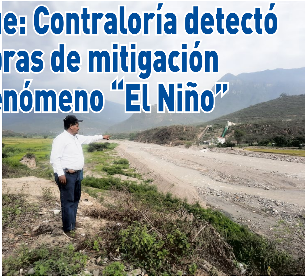
● Obra deficiente: Sr. Faustino Taboada Jaramillo, vicepresidente de la Junta de Usuarios del Sector Hidráulico Chancay-Lambayeque, mostrando el dique de arena y tierra que se vinieron abajo con la crecida del río Reque, en el centro poblado Callanca, distrito de Monsefú, Lambayeque.
